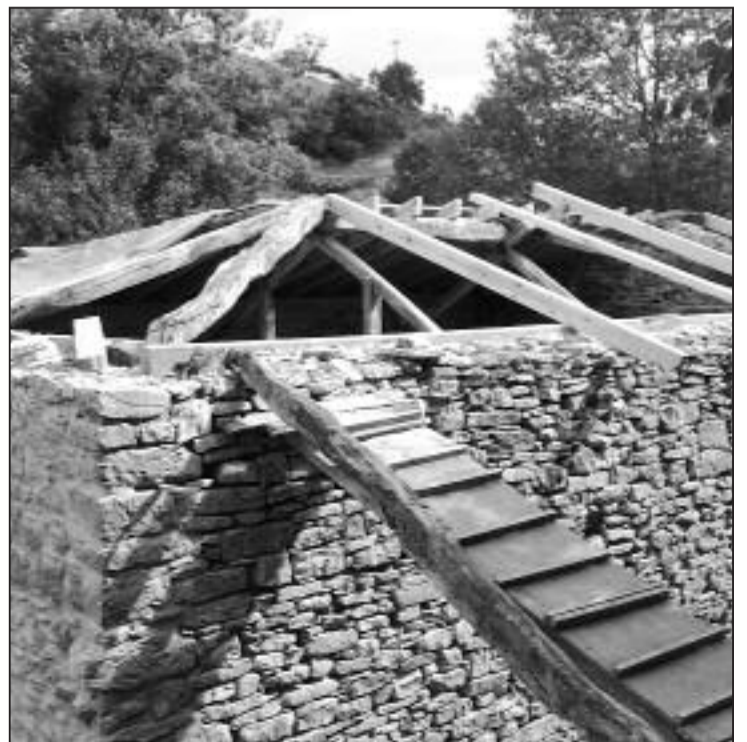
► Aspecto que presentaba el tejado antes de la intervención
