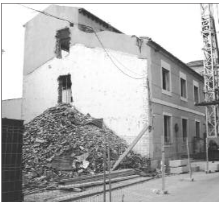
► La previsión más reciente pasa por derruir el edificio
