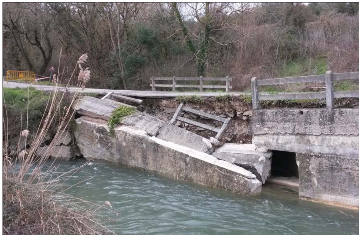
Muro caído, debido al descalce en el pie por la erosión del agua.
