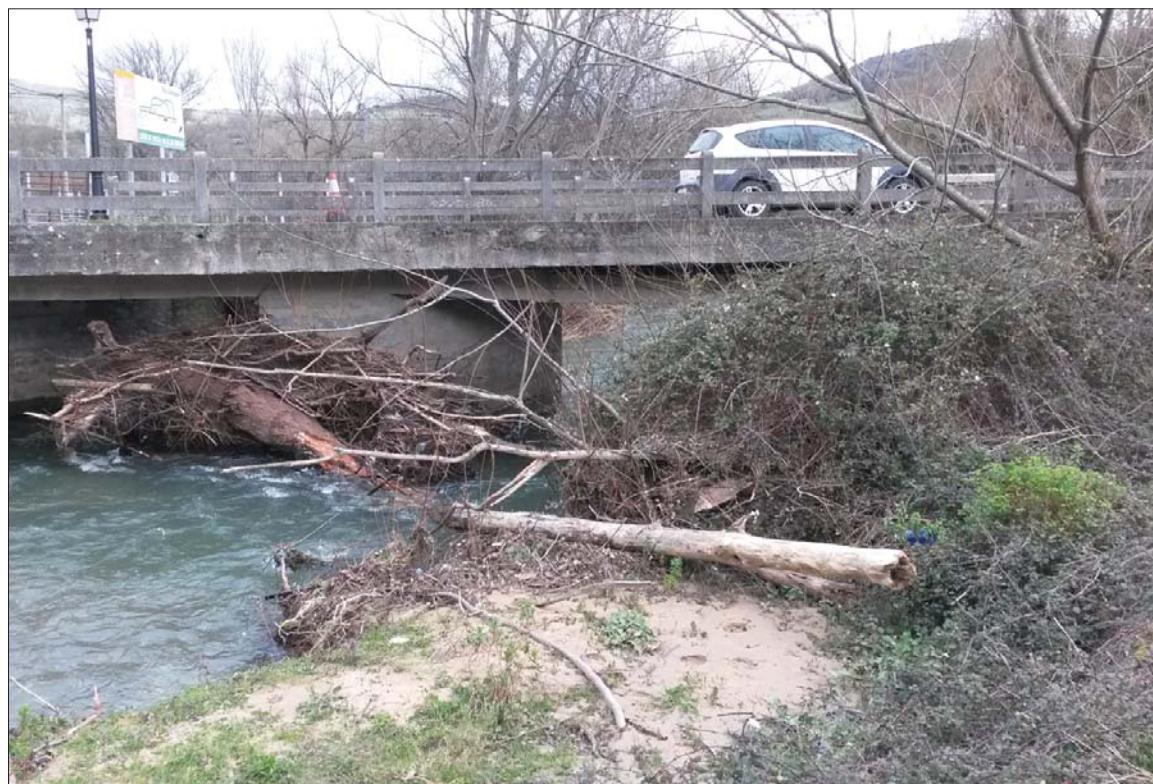
Material arrastrado por la riada acumulado en los ojos del puente y sedimentación de arenas en la zona interior del lecho.
